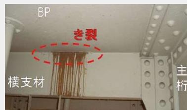
写真1：き裂発生事例
